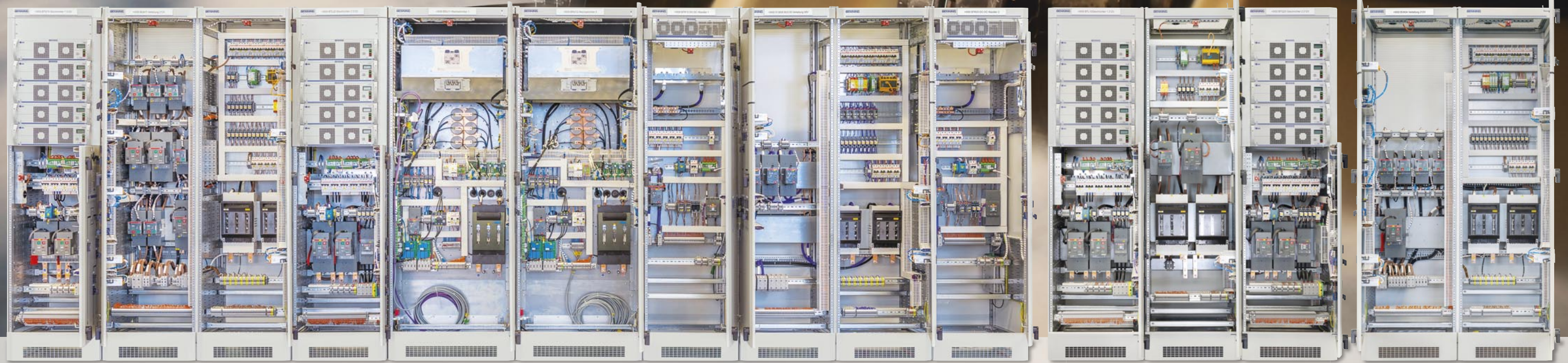
Motorbetriebene Leistungsschalter in den von BENNING gelieferten Verteilersystemen ermöglichen eine vollständig automatisierte Betriebsführung durch die Leitwarte in allen systemrelevanten Spannungsebenen der Kraftwerke
