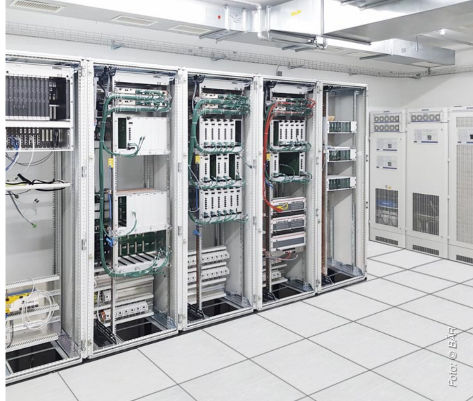
Blick in das neue Gebäude der Stellwerksanlage Montbovon während der Installation. Die Stromversorgungsanlage EUROLOCKING® von BENNING (Hintergrund) sichert das Herz des Stellwerks – das SPS-Steuerungssystem – gegen Netzstörungen ab.
