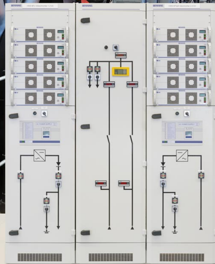
Stromversorgungssystem der 40-Megawatt Schaltanlage
