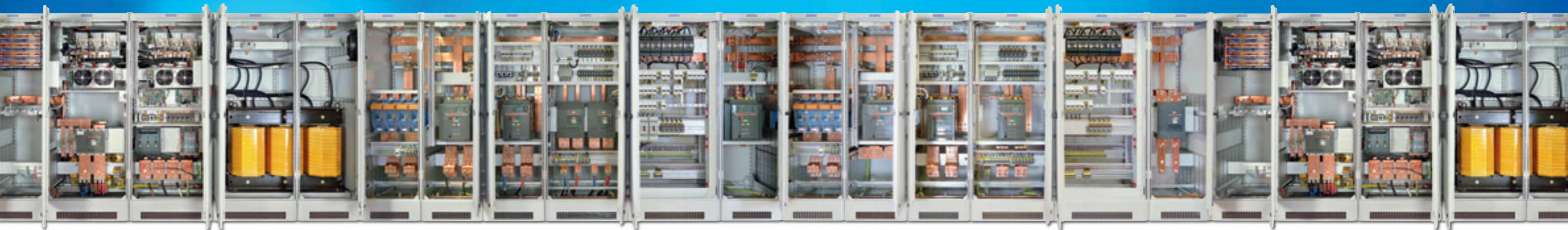
Système d'alimentation 125 V/DC pour une centrale conventionnelle, constitué de blocs redresseur de 1750 A et 60 kVA, Convertisseurs DC/DC TEBECHOP modulaires et câbles de distribution correspondants
