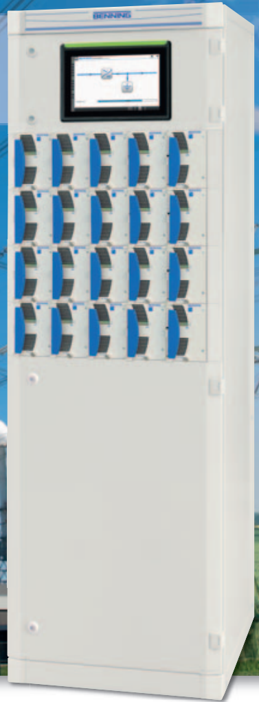
Рис. 3: Система електроживлення постійного струму потужністю 60 кВт, що складається з 4 корзин випрямлячів, у кожній з яких розташовані 5 модулів (максимальна вихідна потужність 15000 Вт).
