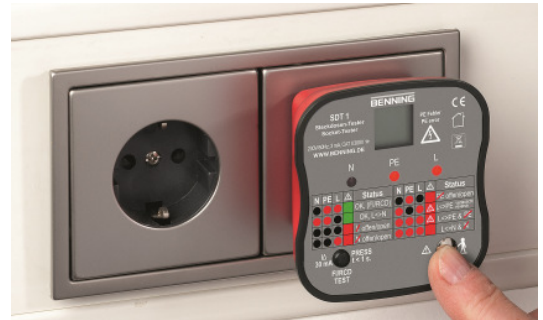
Stekkerdoos correct gemonteerd, vingercontact controleert het PE-contact op gevaarlijke aanraakspanning
