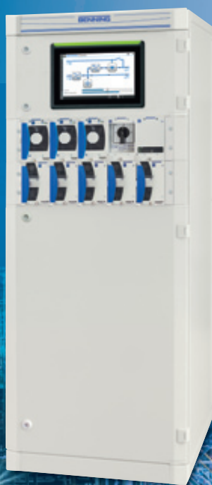
Выпрямительно-инверторный шкаф (Рис.5)
