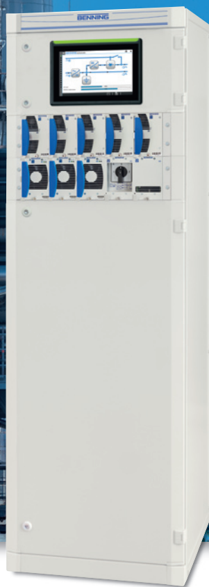
Gleichrichter-Wechselrichter Systemschrank (Abb. 1) Dieses System ist mit 3 Wechselrichtermodulen, EUE und Handbypass, Ausgangsleistung 4,5 kVA, Ausgangsspannung 220 V DC, Ausgangsstrom 50 A DC bestückt.
