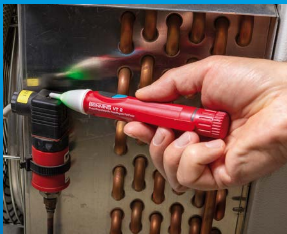
Contrôle d'une électrovanne avec l'appareil BENNING VT 2
