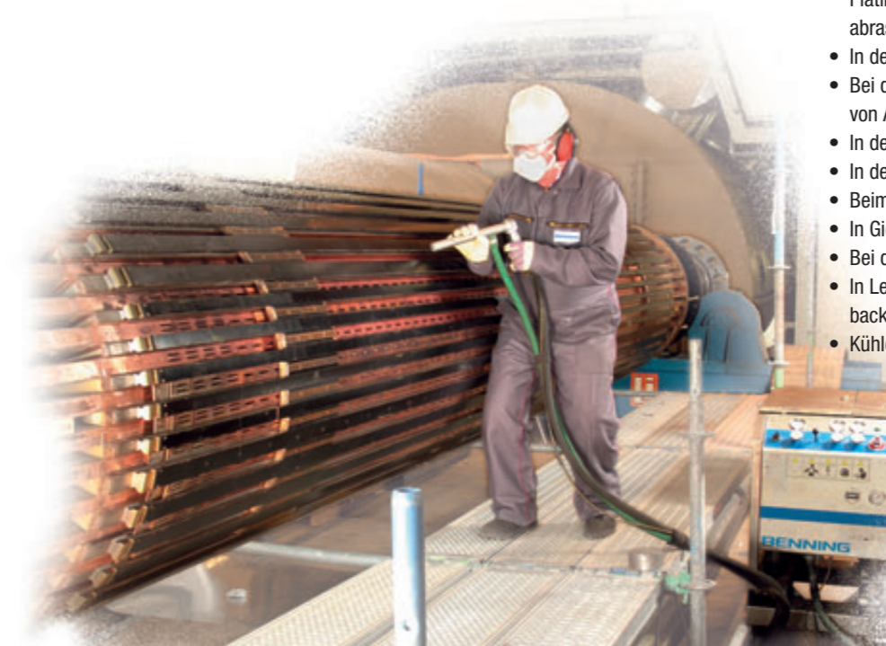
Trockenschneereinigung eines Induktors vor Ort
