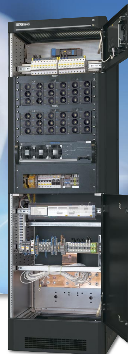
Obr. 7: Kombinace usměrňovače (72 kW) a střídače (7,5 kVA) v jednom systému
