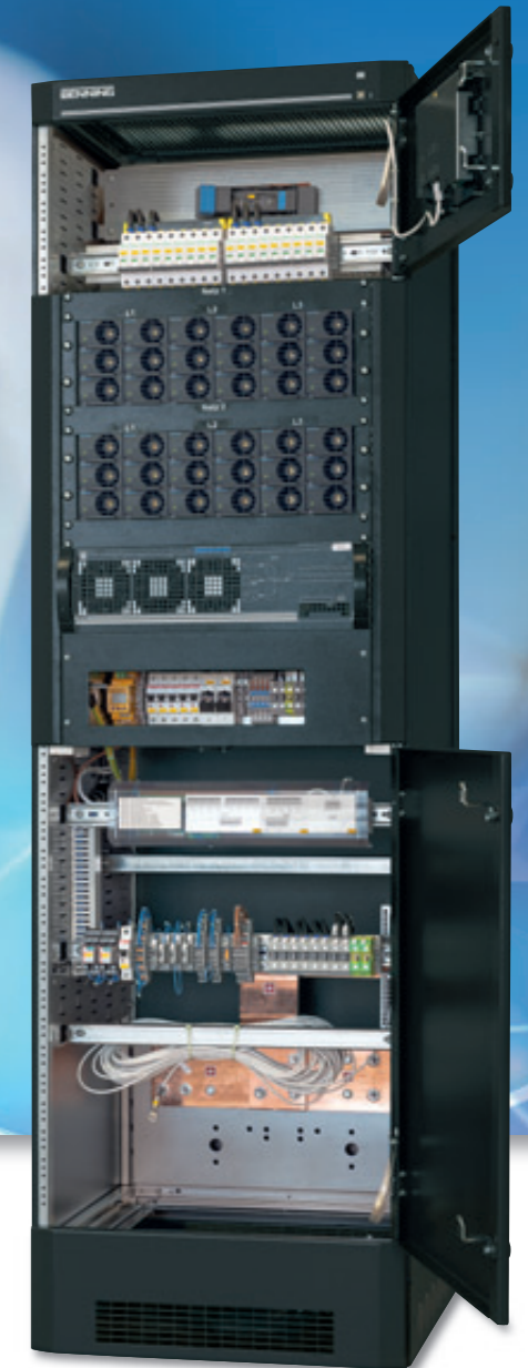
Slika 7: Kombinacija ispravljača (72 kW) i izmjenjivača (7,5 kVA) u jednom sustavu
