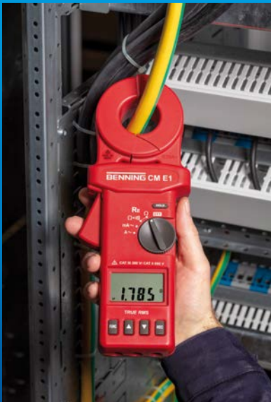
Bedrijfsaarding van een industriële installatie
