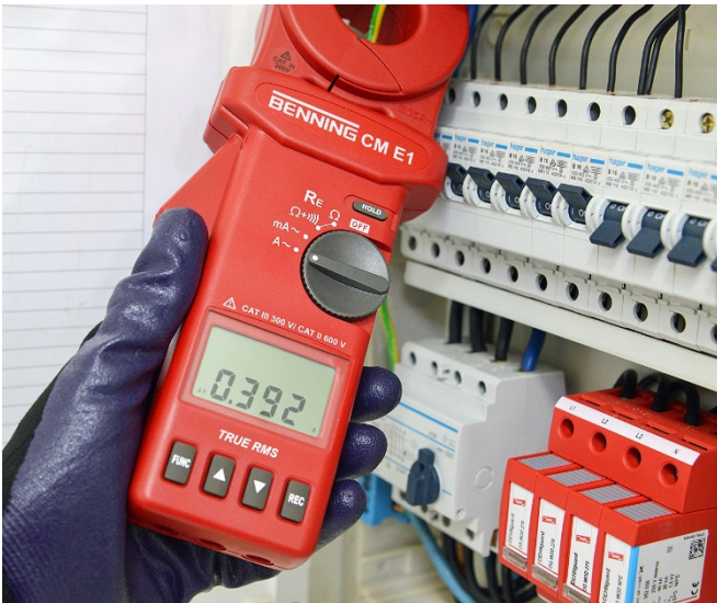
Messung des Gesamt-Ableitstroms in einer Unterverteilung.
