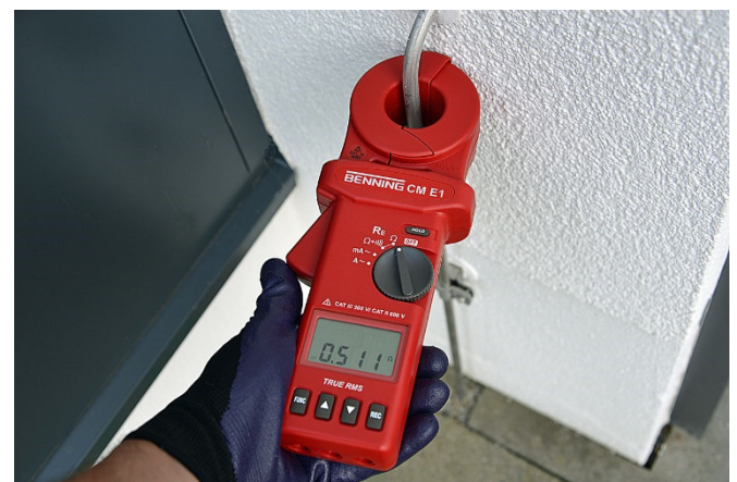
Prüfung einer Blitzschutzanlage mit der BENNING CM E1: Erdleiter mit Zange umfassen, Messwert ablesen, fertig.
