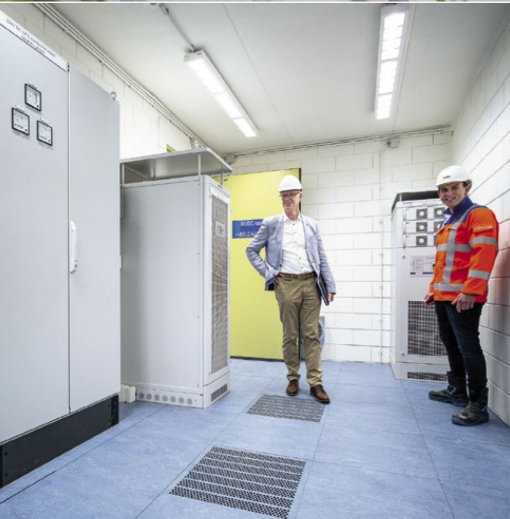
Blick in die Hochspannungs-Schaltstation Borssele während der Inspektion. Zwei USV-Systeme des Typs ENERTRONIC modular SE (jeweils 60 kW) und zwei Gleichrichtersysteme (220 VDC / 200 A) von BENNING (Hintergrund) sichern die Schaltstation gegen Netzstörungen oder -ausfälle ab.
